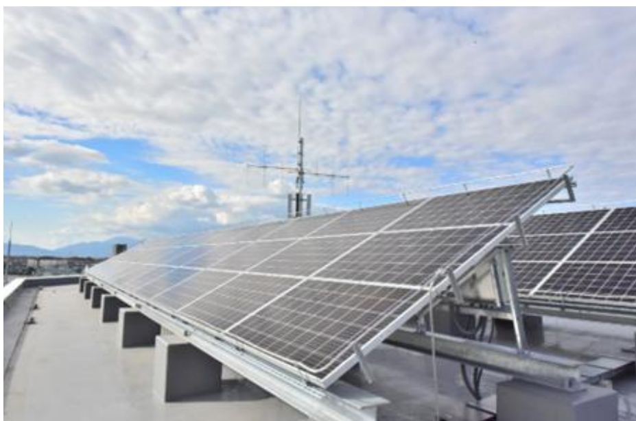
【本庁舎屋上の太陽光パネル】
