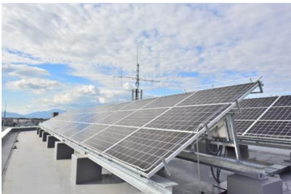
【本庁舎屋上の太陽光パネル】
