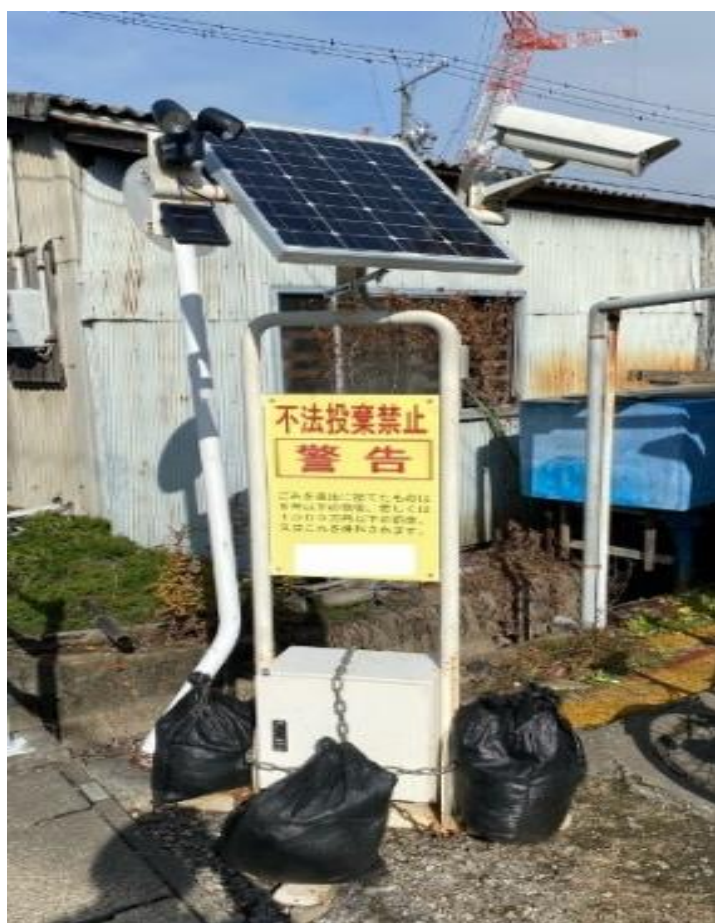
【不法投棄等防止機材（ソーラー式監視カメラ）の写真】
