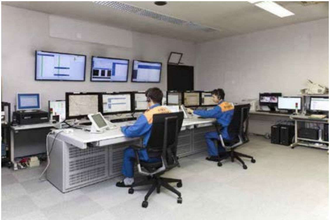
高機能消防指令システム
