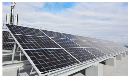
太陽光や地中熱など 自然エネルギーを活用
