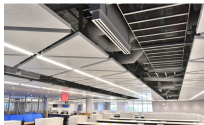
効率化された照明・空調システム 省エネルギーを実現
