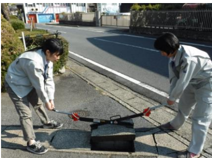
③爪部がふたをつかんでいることを確認し、両側から同時に上へ引き上げます。
