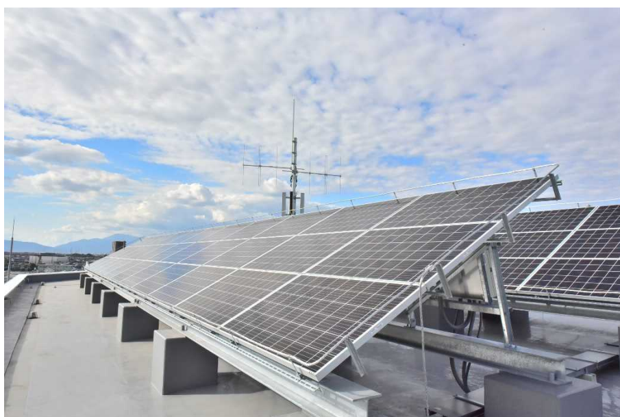
本庁舎屋上の太陽光パネル
