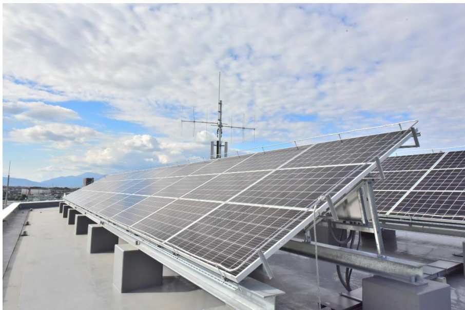
本庁舎屋上の太陽光パネル
