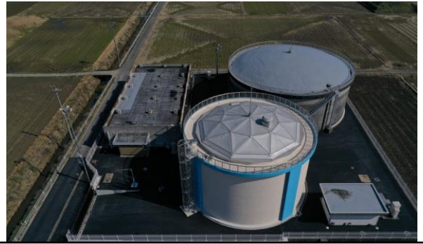
地下水を汲み上げる施設・小熊水源地
