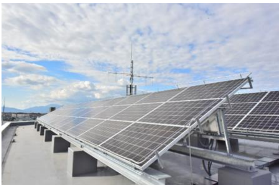
【本庁舎屋上の太陽光パネル】
