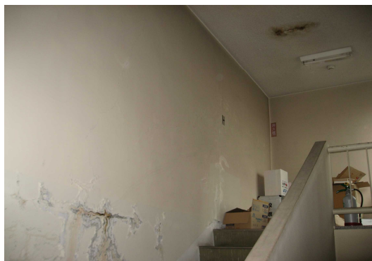
①階段(壁の剥がれ)
