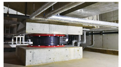
免震基礎構造による耐震性を確保した防災拠点
